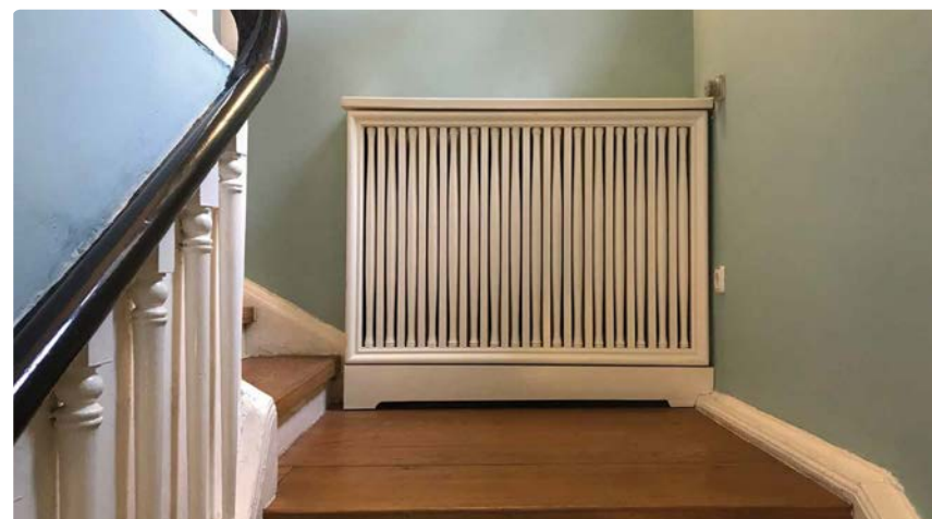
Wie ein Gruß an den Aufsteigenden – Heizkörper am Treppenabsatz
